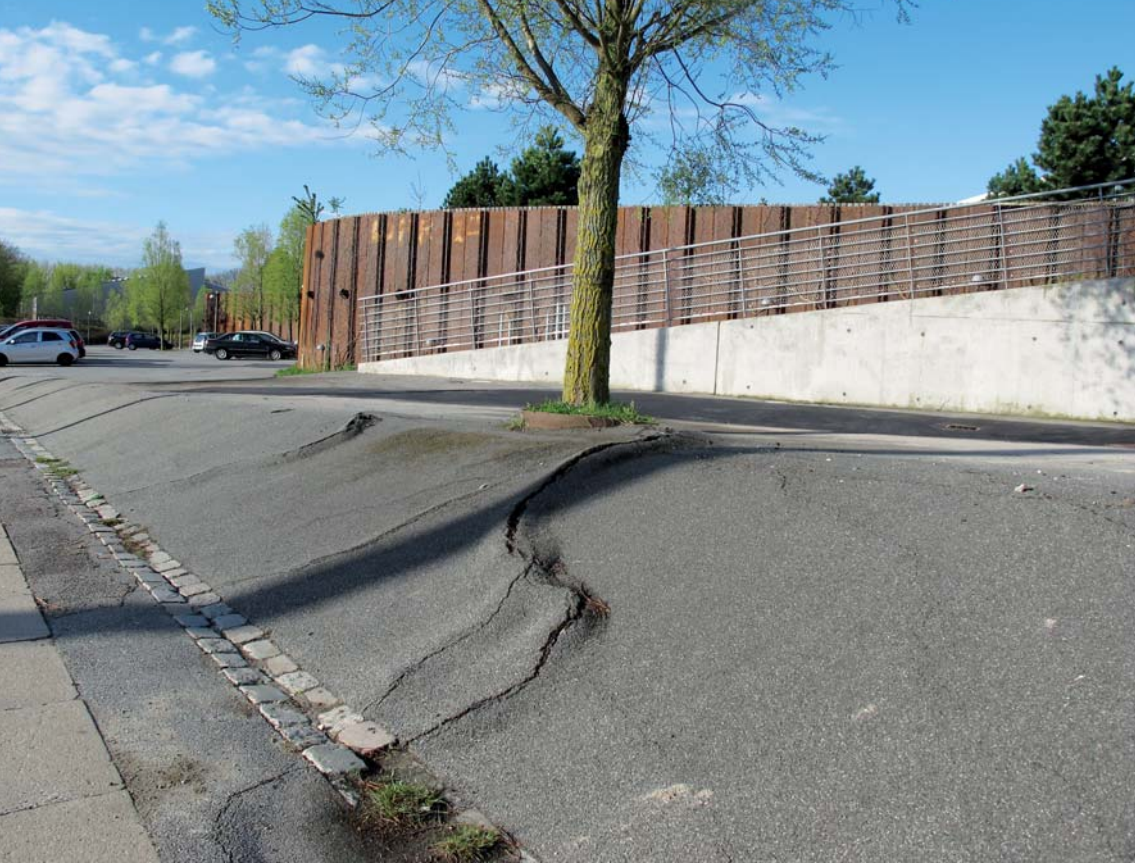
Rødder som vokser sig tykke, løfter og revner asfalten, men det skyldes at træerne har det for surt.
